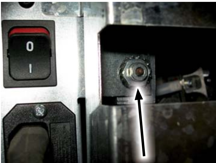
Réarmement du bulbe du réservoir 85°C
