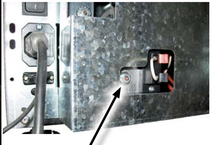
Réarmement du bulbe de l'eau 100°C
